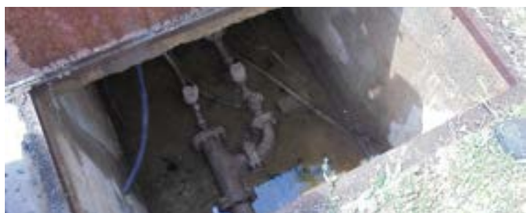
Exemple de compteurs d'eau bétonnés problématiques
