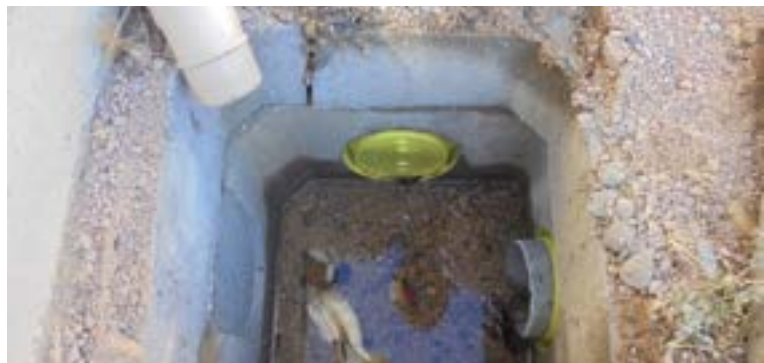
Exemple de descentes de chéneaux avec décanteur
