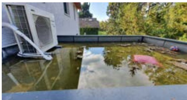
Illustration de toitures-terrasses problématiques retenant l'eau
